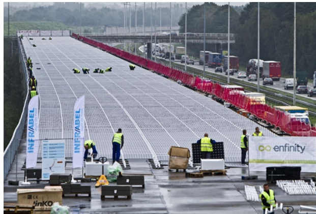
Установка солнечных панелей на крыше железнодорожного тоннеля в Бельгии (источник: pv magazine )
